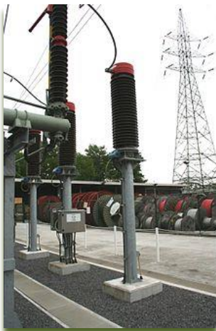
Сл. 4.2: Напонски мерен трансформатор
